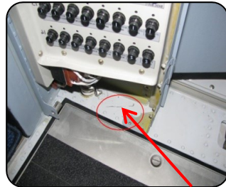
Drut w skrzynce z bezpiecznikami
